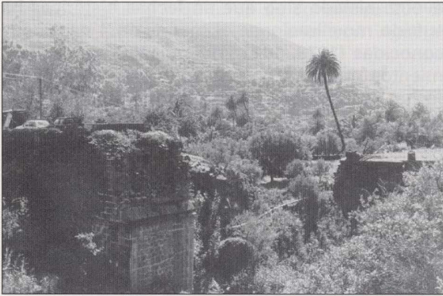
Foto 1. Efectos del deslizamiento de Rosiana de 1956; el puente definitivamente roto y palmeras inclinadas por el movimiento.
